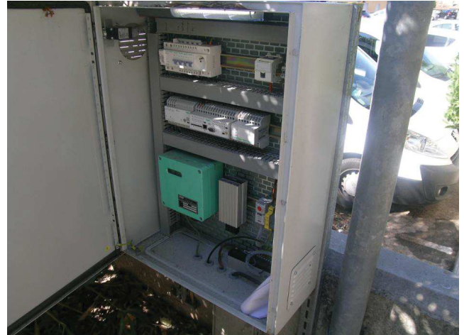
Armoire de commande de débitmétrie
