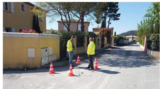
Recherche de fuite
