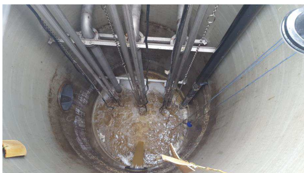
Poste de relevage des Tuileries
