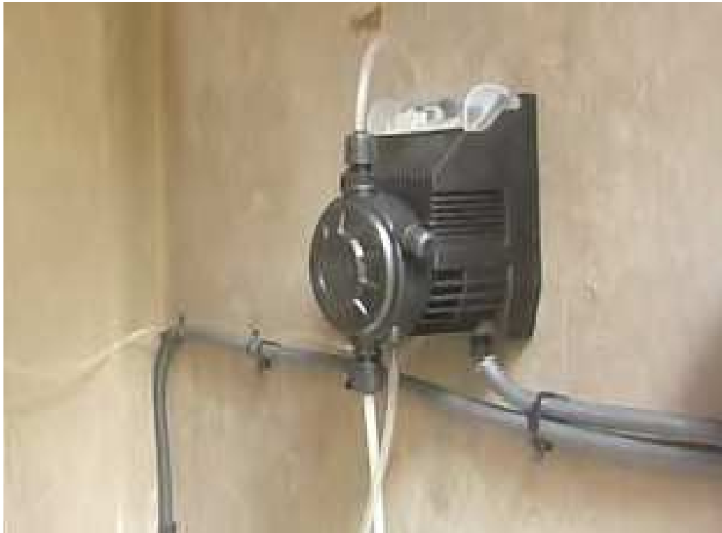
Installation de la pompe doseuse « Aqua Pump HC100 » Reglage du débit d'injection d'eau de Javel : 0,3l/h de pompage
