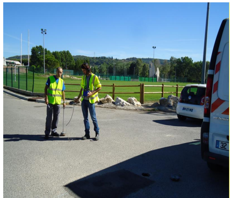
Recherche de fuite
