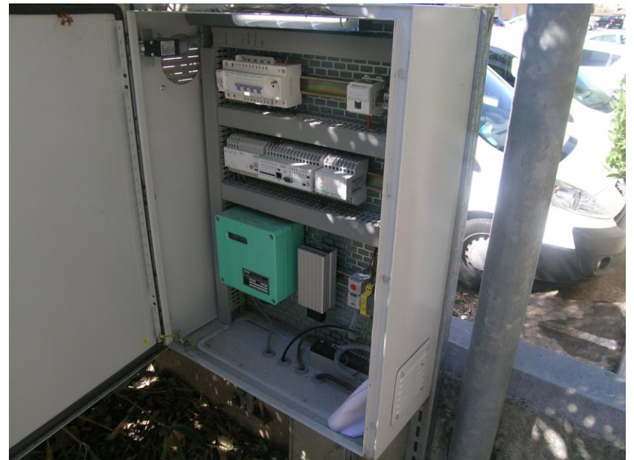
Armoire de commande de débitmétrie
