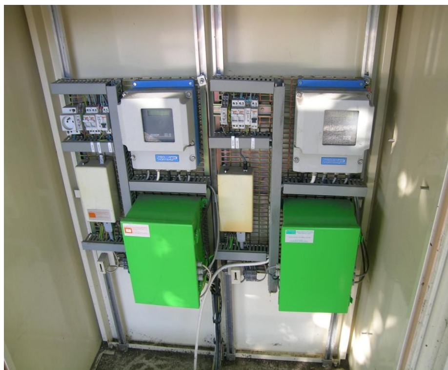
Armoire de commande débitmétrie
