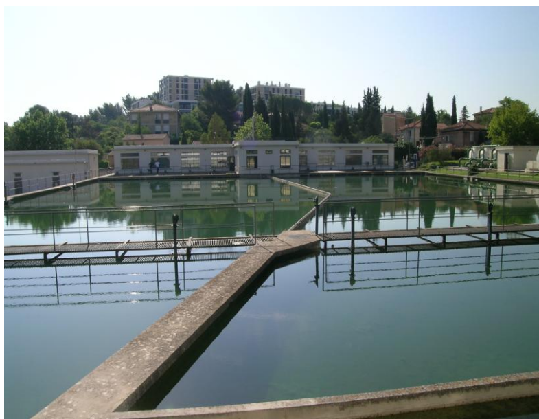
Bassins de décantation de Saint Eutrope
