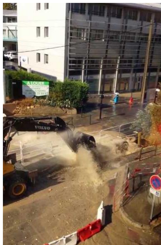
Fuite chemin du Club Hippique
