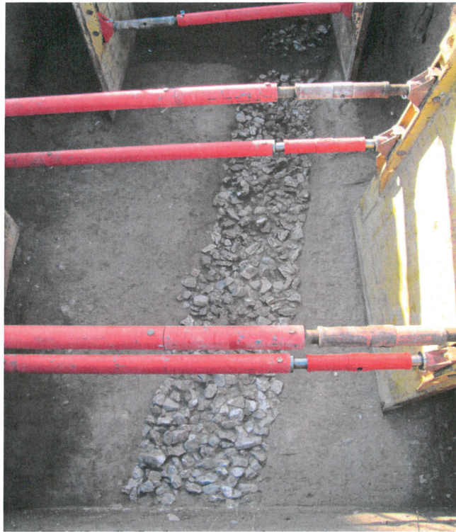
Arase du mur de clôture sud du couvent des dominicaines de Notre Dame de Nazareth, fin XIIIe-milieu XIVe siècle.
