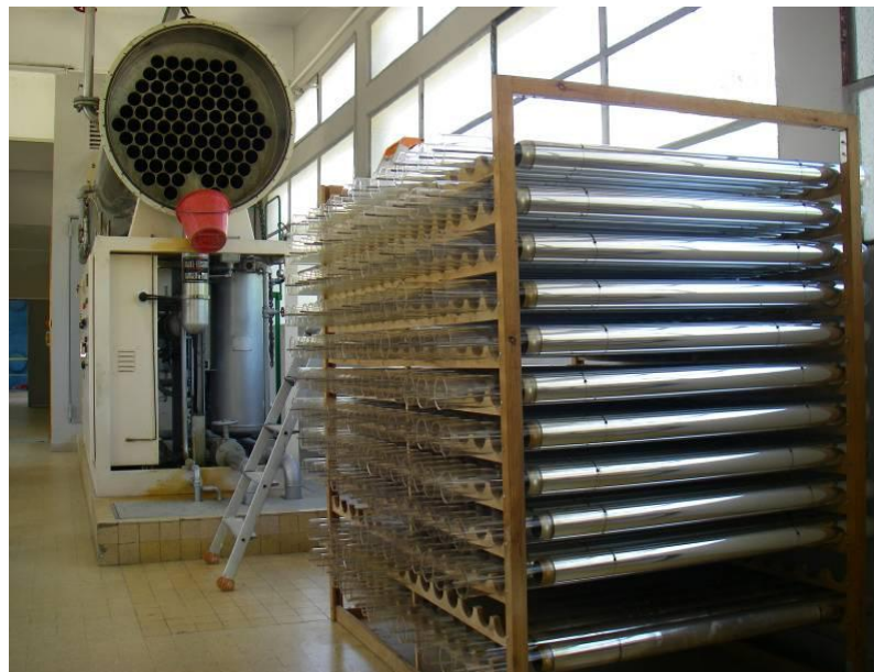
Ozoneur de Saint Eutrope et tubes diélectriques de rechange
