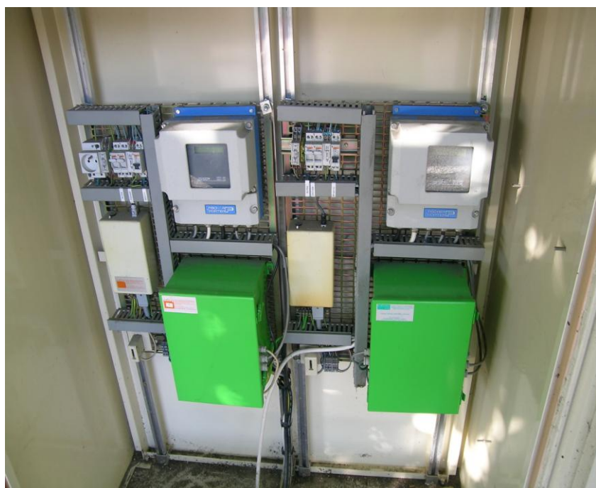
Armoire de commande débitmétrie
