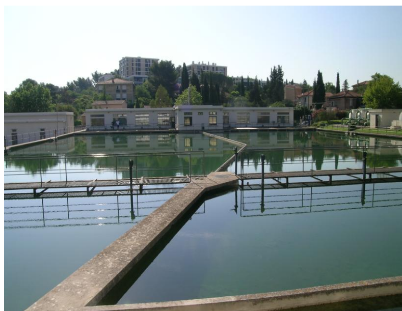
Bassins de décantation de Saint Eutrope
