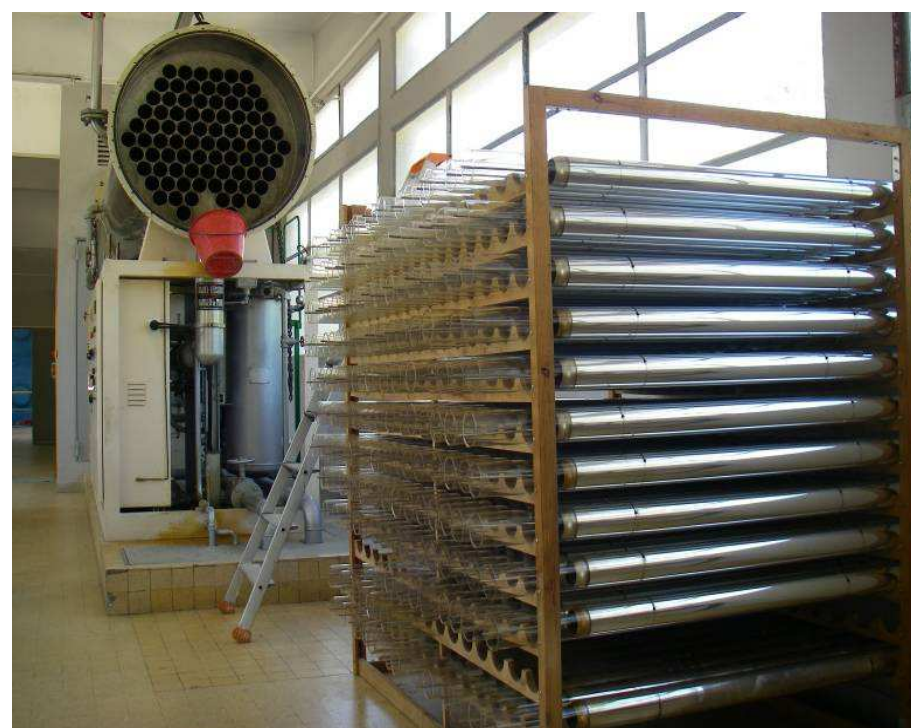
Figure 5: Ozoneur de Saint Eutrope et tubes diélectriques de rechange
