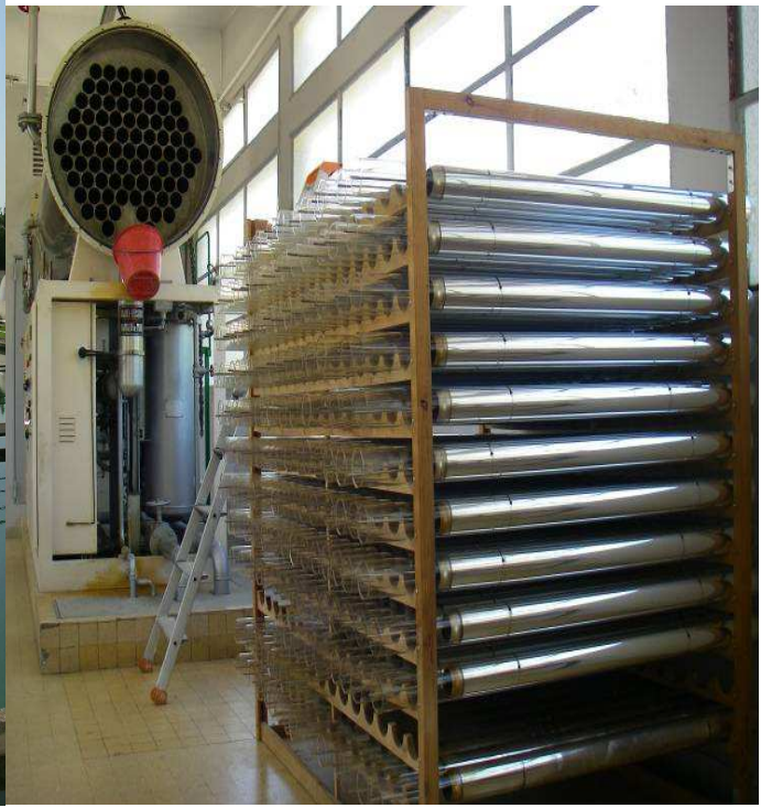
Figure 5: Ozoneur de Saint Eutrope et tubes diélectriques de rechange
