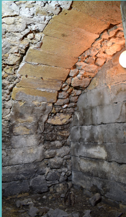
Fig. 16. 1, rue Manuel, hôtel de La Cépède. Escalier d'accès aux caves. Photo Marc Panneau.
