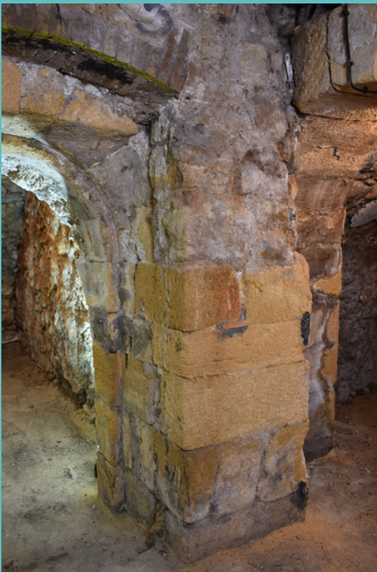
Fig. 18. 1, rue Manuel, hôtel de La Cépède. Sous-sols. Piédroit sud d'une porte. Photo Marc Panneau.
