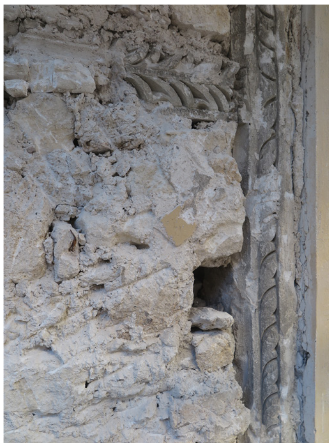
Fig. 23. 10, rue Mignet, hôtel de Gassier. Décor des encadrements de fenêtres disparues. Photo Claire Auburtin.
