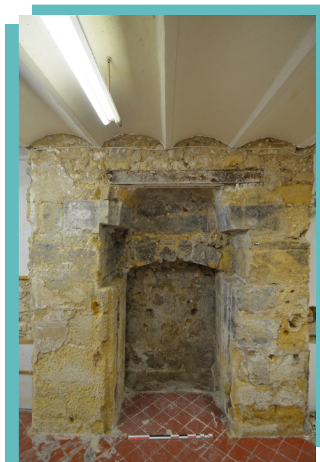
Fig. 14. Collège des Prêcheurs. Bâtiment nord-est. Pressoi à chapelle d'un moulin à huile aménagé dans le couvent. Epoque moderne.
