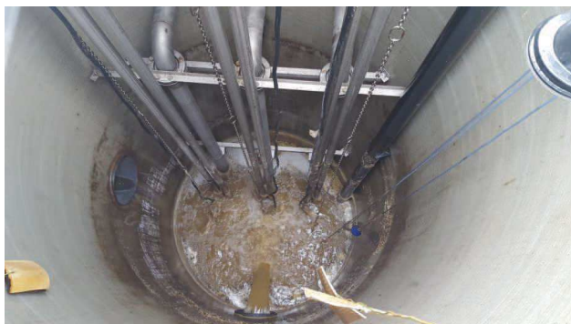
Poste de relevage des Tuileries
